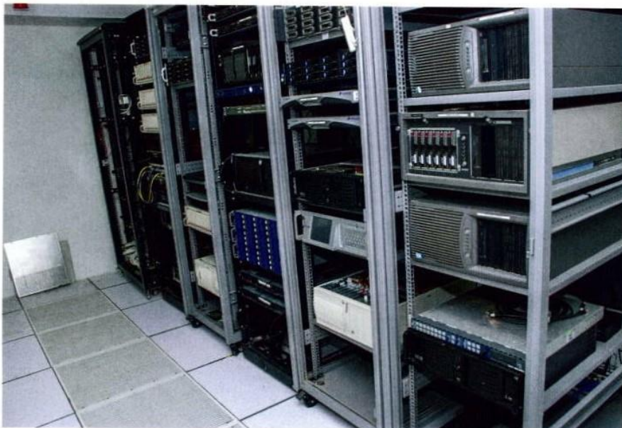
▲ UFO’s server room
